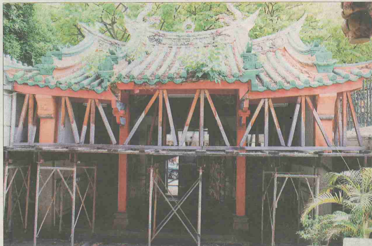
庆德楼的山门, 目前靠铁架和木条勉强支撑, 随时有坍塌危险。(庆德会提供)
